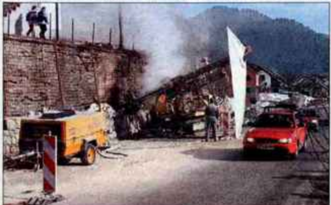
V Selcih jih čaka tudi izredno zahtevna obnova opornega zidu.
