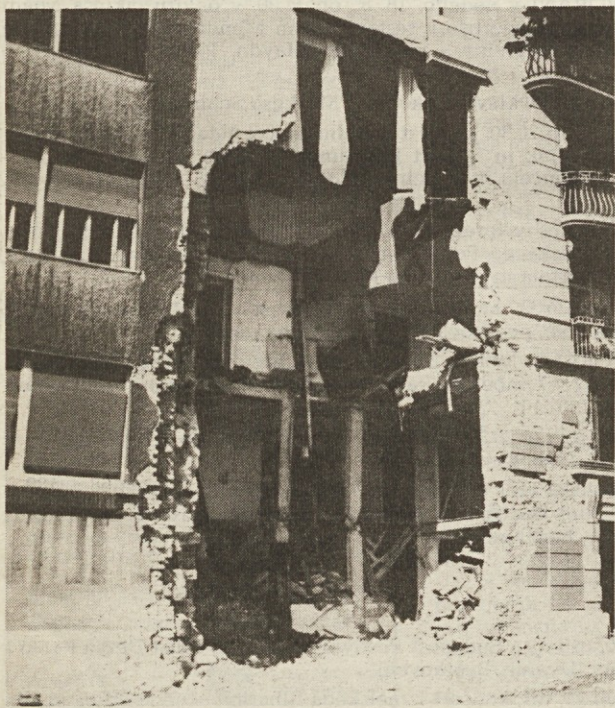
V poslopju v Ul. Locchi je včeraj zevala še večja odprtina
