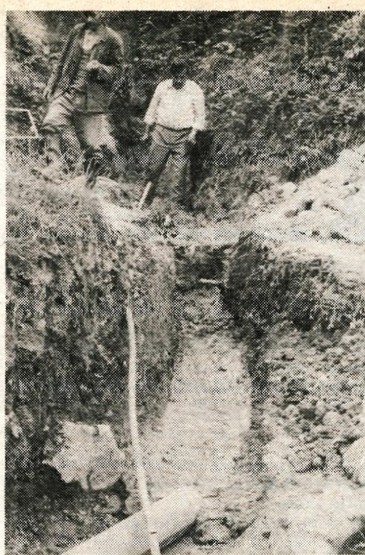
Zemeljski plazovi so v jeseniški občini napravili kar precej škode. Najhujša sta bila zemeljska plazova na Blejski Dobravi in nad Splošno bolnico na Jesenicah. Zdaj so na Jesenicah že začeli s sanacijo, med drugim tudi za bolnico, kjer bodo zaustavili premikanje ilovnatih plasti. Na sliki: kanaliziranje vode največjega izvira na Žerjavcu. — Foto: B. B.
