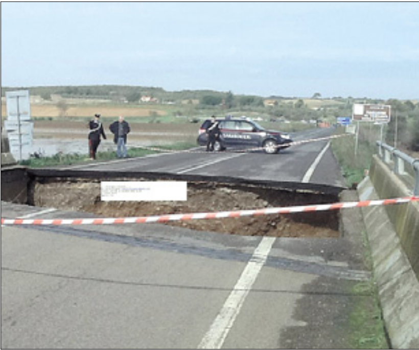
Porušeni most nad reko Albegno, s katerega je strmoglavil avtomobil in terjal tri žrtve
