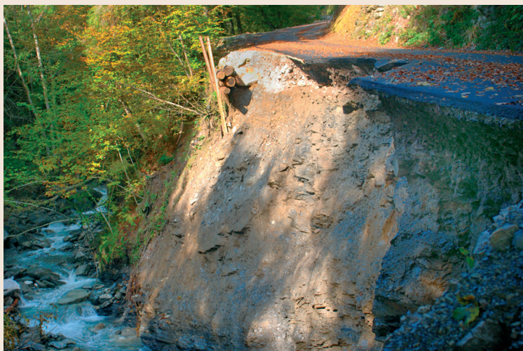
Slika 18: Spodkopana cesta nad Železniki, september 2007
