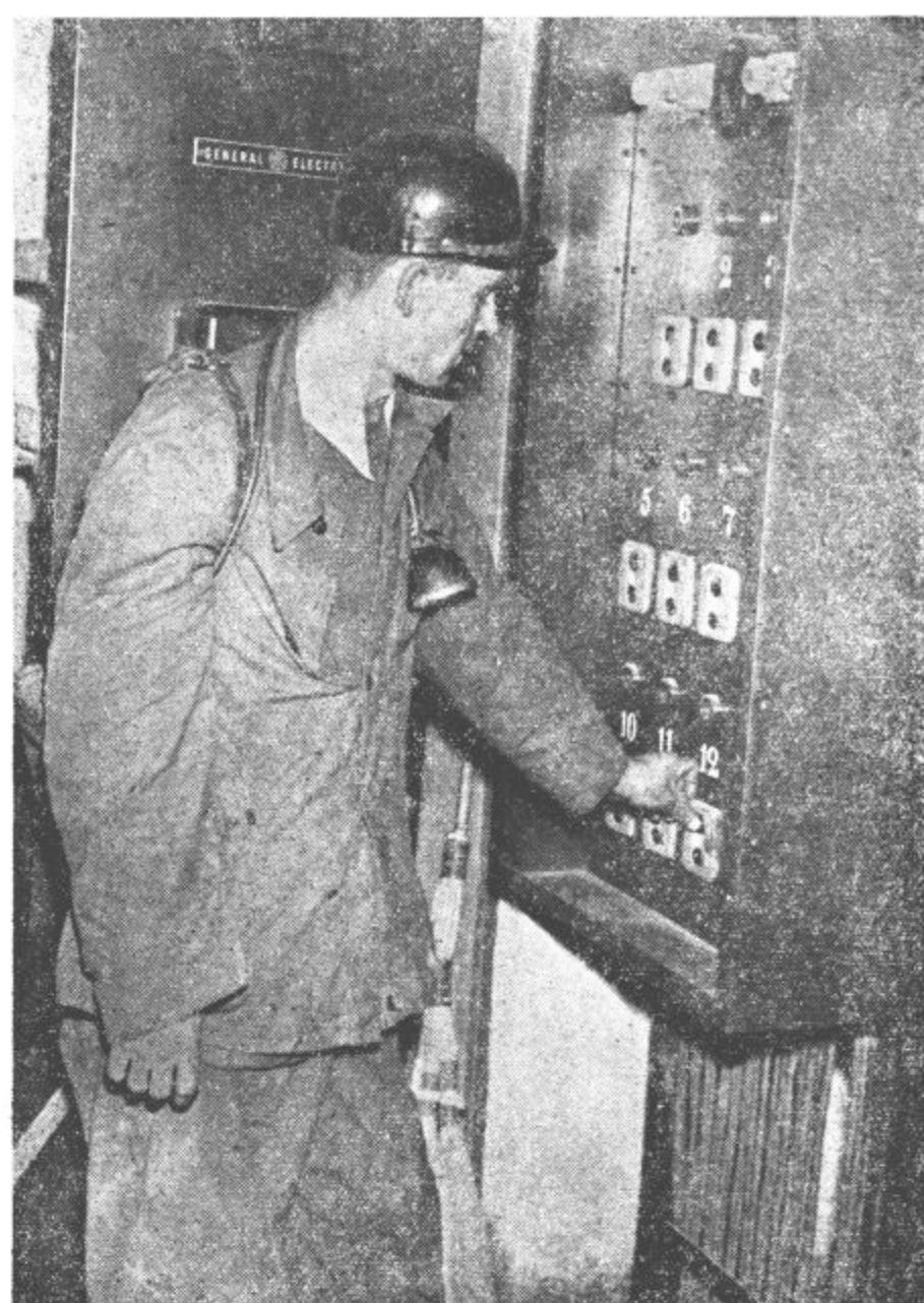
Dežurni električar pri stikalcu v jamski trafopostaji
