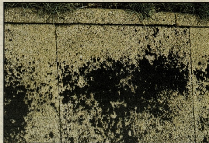
Mah se naseli tudi tja, kjer trava ne raste, če le tam voda vsaj malo zastaja. Betonske, kamnite in druge podobne površine porjavijo, če sredstvo zaide vanje.
