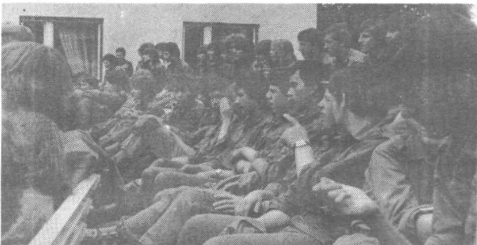
Jarek za vodovod do Dobravice so kopali tudi fantje in dekleta iz šolskega centra za obrambno vzgojo na Igu
