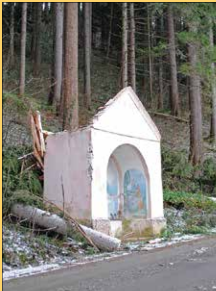
Drevo, ki je zaradi vetra padlo na kapelico, je uničilo njeno streho. (Foto: Štefka Sem)
