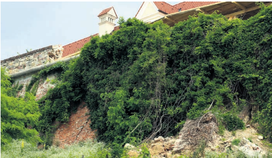
Korenine zelenja, ki prekriva zid, so se vrasle v režo med opeko in kamenjem. Posledično so se ustvarile razpoke, zid je bil dodatno izpostavljen vremenskim vplivom: vodi, zmrzali, visokim temperaturam ...
