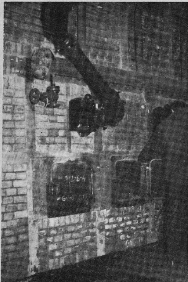
Kurišča novega parnega kotla
