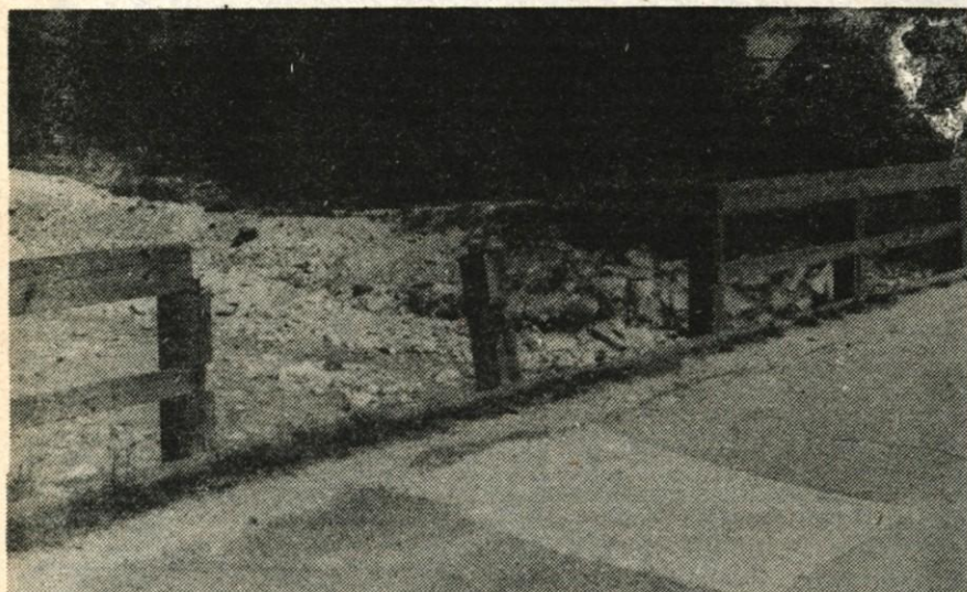
Kranjska gora – Ograjo na starem mostu preko Pišnice v Kranjski gori je kar krepko načel zob časa. Tako ostaja nevarnost, da bi kdo iz nepazljivosti padel v strugo reke, ki je precej globoka. Res je, da so ograjo pred dnevi zavarovali z varovalno vrvo, toda to ne bo veliko pomagalo, kajti most je ponoči premalo osvetljen. Tako varovalna vrva ne bi držala, zato je treba ograjo čimprej popraviti. – Foto: A. Kerštan
