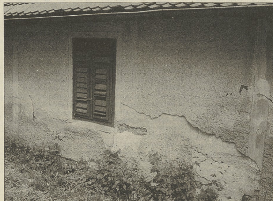
V vasi Lopersice vzhodno od Ormoža je prišlo do obsežnejšega odpadanja ometa
