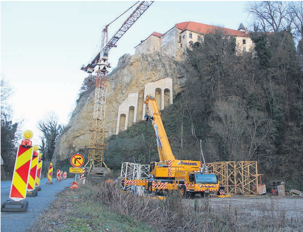
Pogled na delovišče, kjer se je v četrtek pri demontaži žerjava smrtno ponesrečil 70-letni Mariborčan. Nesreča se je zgodila ob 16. uri, ko se je dan že prevešal v večer. Zaradi teme so preiskavo nesrečnega dogodka v četrtek prekinili in jo nadaljevali naslednji dan.
