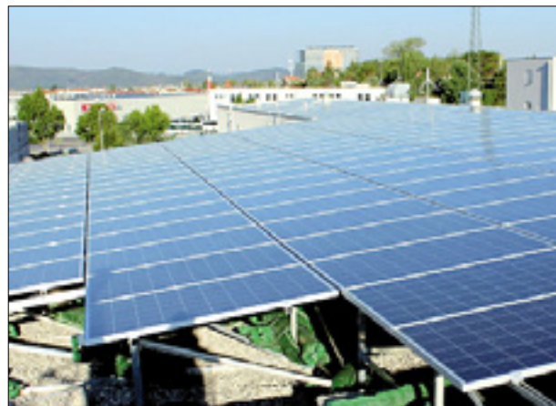
Elektrarna na strehi Hitovega Servisnega centra
