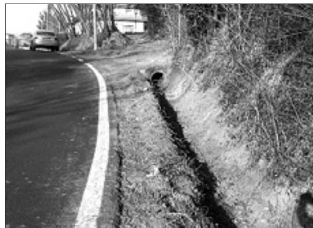
Obcestni kanal v Ulici Sottomonte
