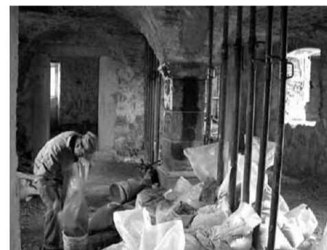
Knjižnica dr. Franca Sušnika, Ravne na Koroškem, 2001-04, med gradnjo. Dr. Franc Sušnik Library, Ravne na Koroškem, 2001-04, construction process.
