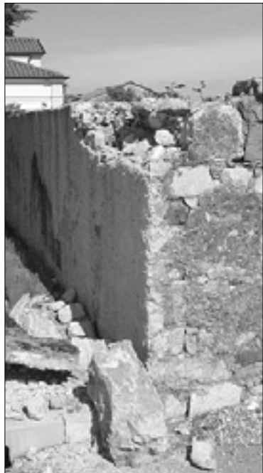
Porušeni zid pokopališča
