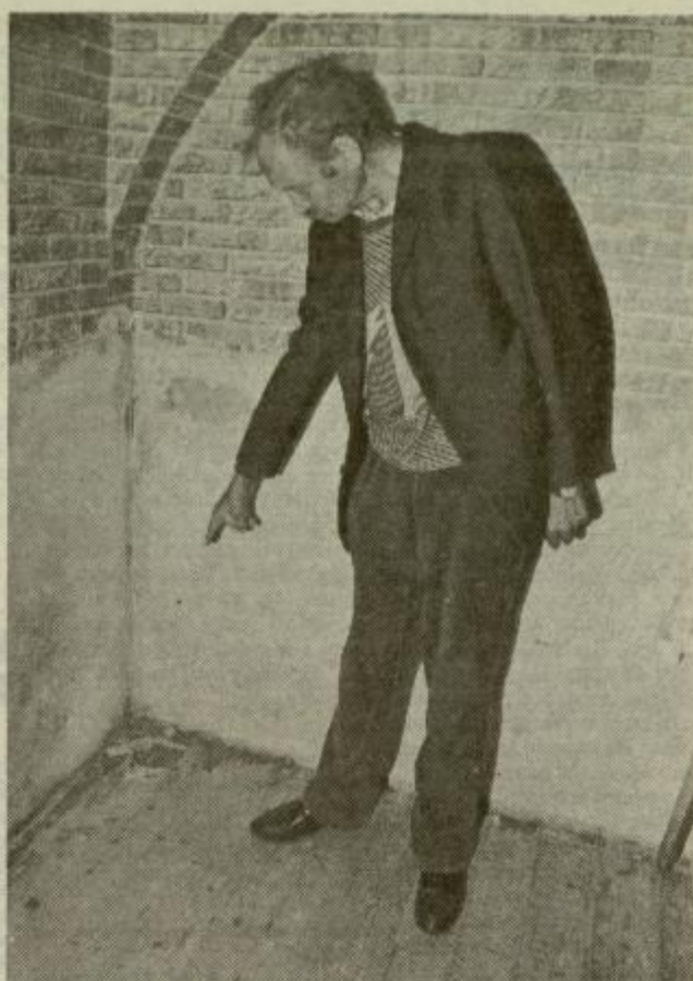
Alojz Kos kaže lesena tla v kuhinji, ki so po robovih že sprhnela.
