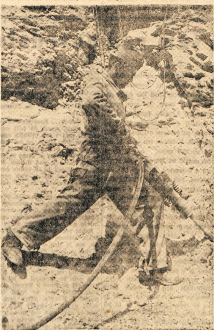
Kompresor trmasto grize v kamen...
