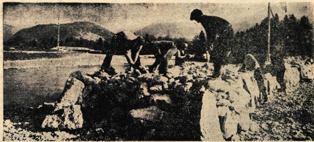
Na brodu v Bohinju se je Sava že zelo približala cesti in vse je kazalo, da jo bo začela spodjedati. Zato so že letos poletni tu zgradili prvi del obrežnega zidu, ki pa ga je oktobrsko neurje precej razdejalo.
