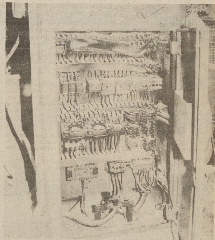
Krmilna omara visokotlačnega livarskega stroja je povsem uničena. Vzdrževalce skrbi, kje bodo dobili potreben material in elektronske elemente.
