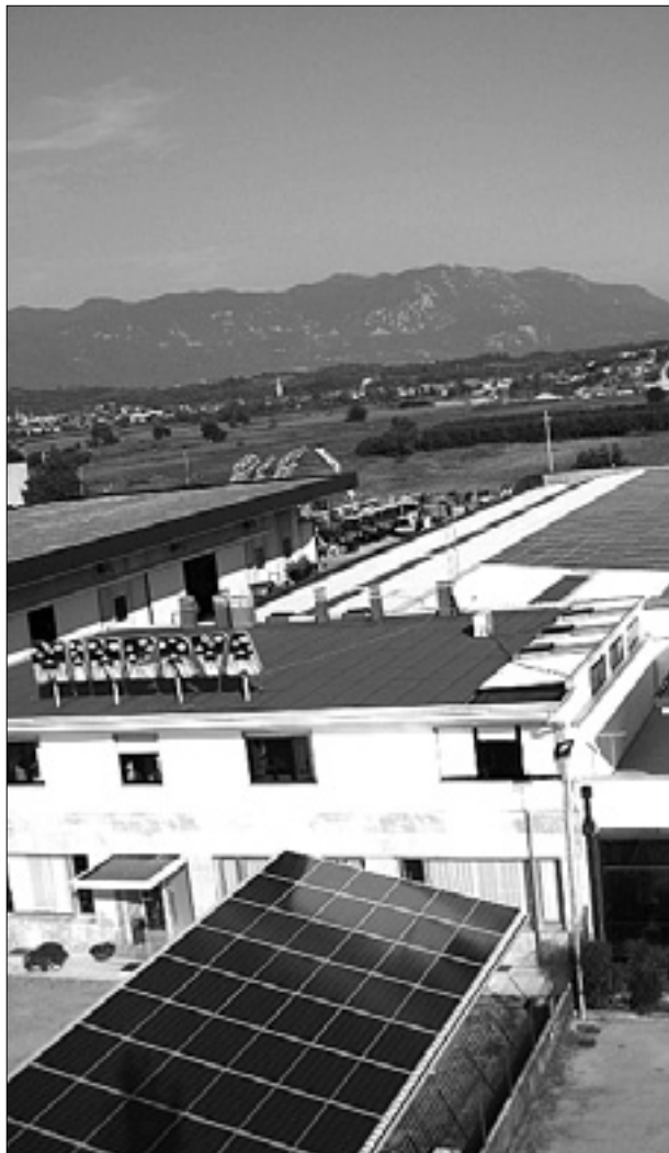
Pri Minervi so s fotovoltaičnimi paneli prekrili 550 kvadratnih metrov strehe. Letno bodo proizvedli 70.000 kilovatnih ur energije; česar ne bodo porabili za lastne potrebe, bodo brezplačno dali na razpolago na električnem omrežju.
