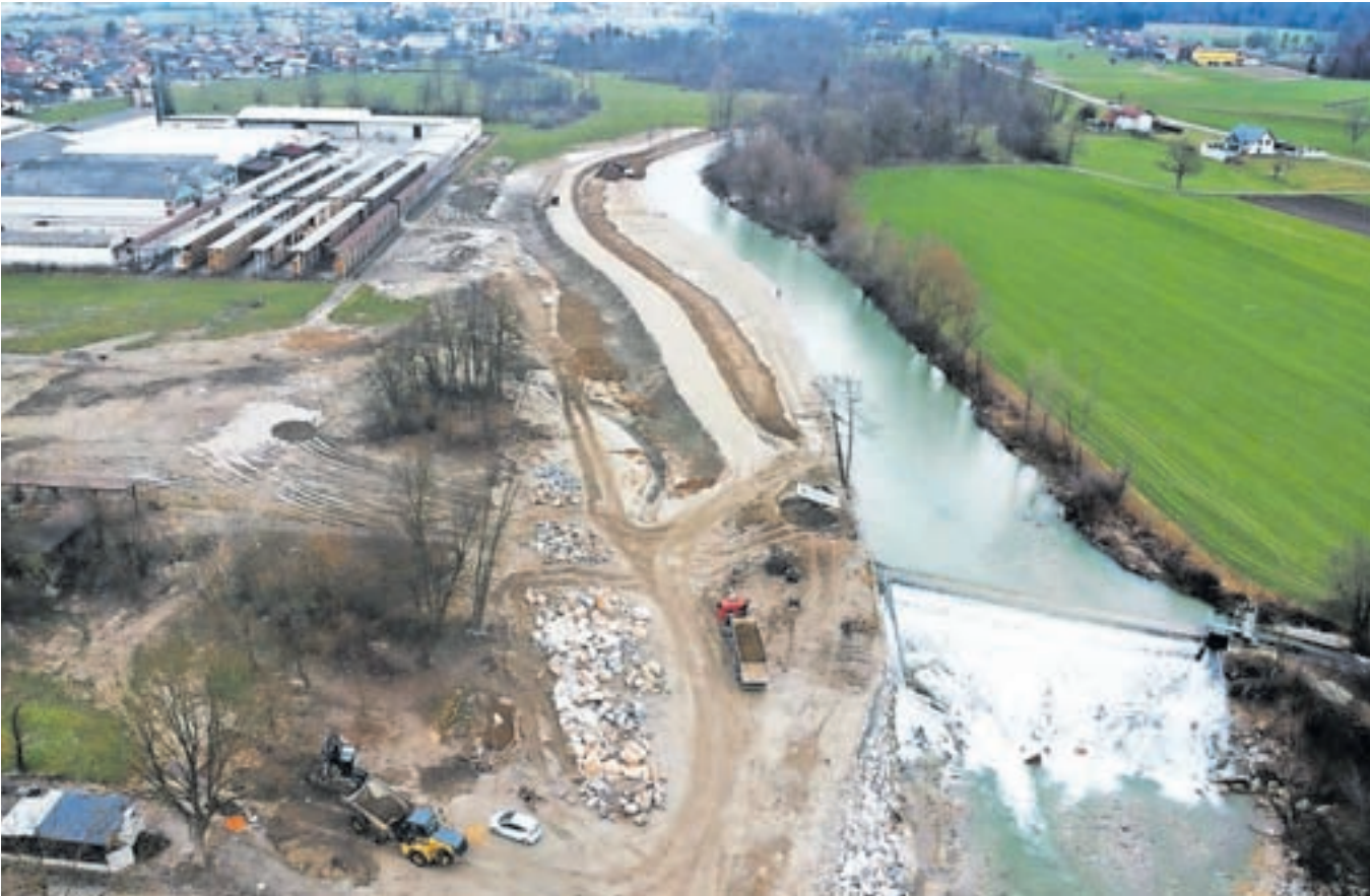
Intervencijski nasip v Šmarci / Foto: Občina Kamnik
