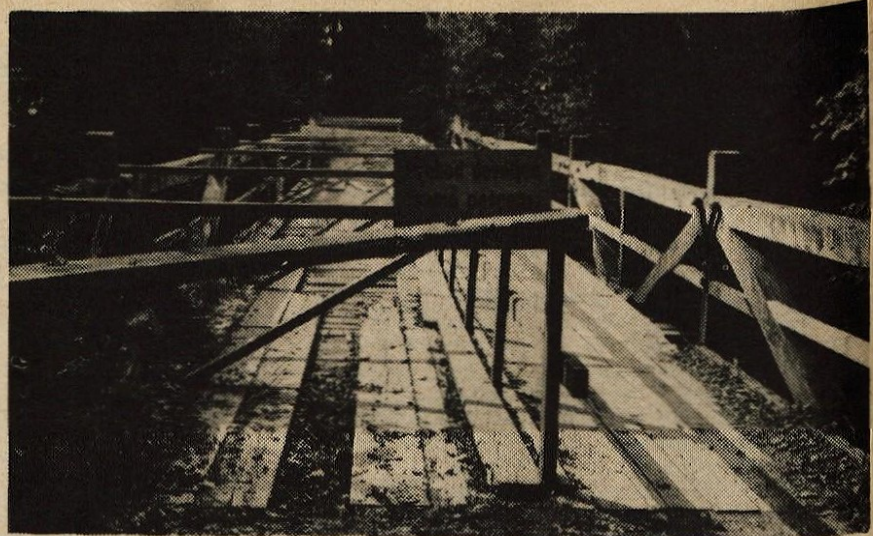
Dotrajan leseni most čez železniško progo je zaprt. Krajevna skupnost Naklo nima denarja ne za obnovo, ne za ureditev klanca Preska. Potrebna bo širša družbena pomoč. (Vse slike F. Perdan)
