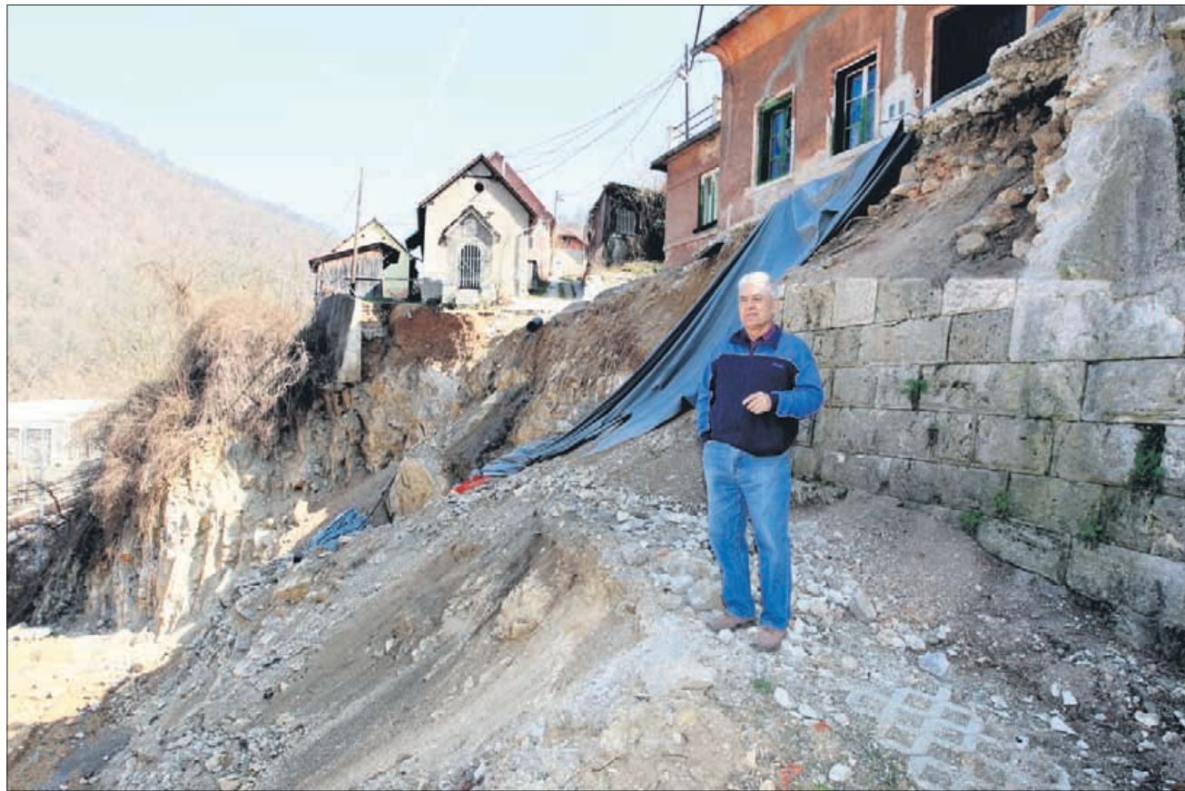
Anton Škegro pred plazom. V ozadju je hiša, ki jo bodo ob sanaciji podrli. Gospo, ki je prej živela v tej hiši, so začasno preselili v blok. Poleg njene hiše bodo podrli še eno, ki je prav tako ob plazu (zgoraj levo), kapelica, ki stoji ob tej zgornji hiši, se bo verjetno podrli sama. Glede slednje so, kot je povedal Škegro, »cerkveni krogi obveščeni«.
