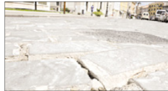
Uničeno cestišče pred cerkvijo Sv. Ignacija na Travniku
