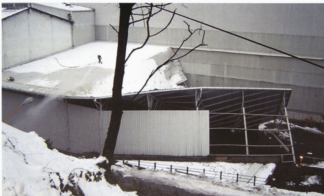
Porušen nadstrešek na južnem dvorišču
