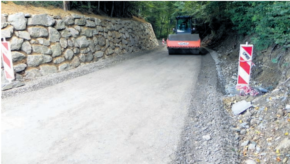
Foto: Arhiv občine Del kamnite zložbe se je po enem samem dnevu udril. Izvajalec bo v začetku tedna izvedel sanacijo.
