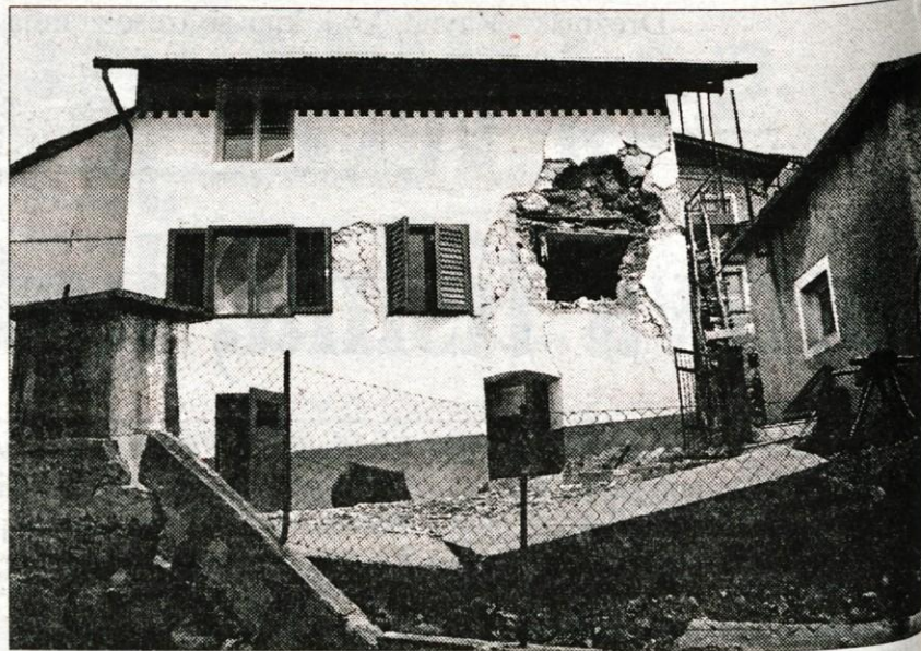
Okno je enostavno odneslo iz zidu
