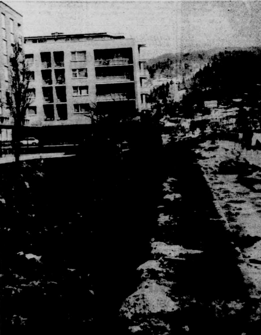
VELENJE UREJAJO — Čeprav slovi Velenje kot mlado in komunalno dobro urejeno mesto, v teh dneh delavci hito, da bi hitro zakopali instalacijske jarko, zaradi katerih je okrnjena avtobusna postaja. Avtobusi stojijo sedaj na cestišču, ker je kanal presekal postajno ploščad. Foto: J. Sever
