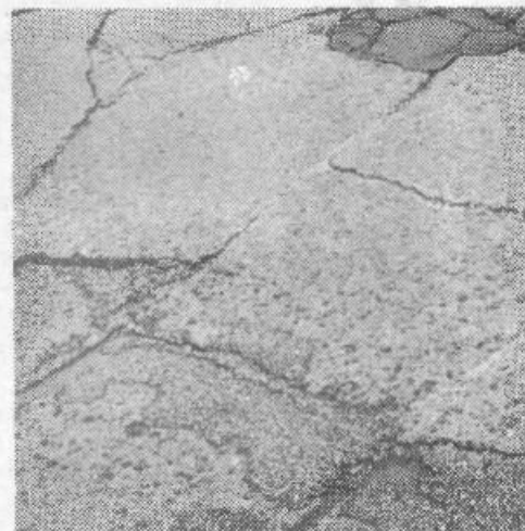
Na cesti od Medvod do Šentvida ni veliko udarnih jam, saj zanje sploh ni prostora. Betonske plošče so namreč tako razpokane in so robovi ponekod že tako visoki, da bi bila kakšna prava jama skoraj v olajšanju. Poleg tega jame cestarji še nekam hitro popravljajo, betonske razbitine pa nikogar ne vznemirjajo. Kaj bo šele potem, ko bo steke promet po obvoznici in bo to postala »lokalna« cesta?
