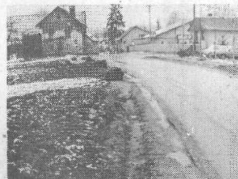
Kadar vozite skozi Gameljne, pazite, ko se boste bližali tovarni Rašica. Lastnik njive ob cesti sicer ni šel orat asfalta, temveč je od nekod privlekel velike kose betona ter ga skrbno zrinil ob in na cesto. Da se ve, kje je njegova njiva in kje se začne cesta? Ker se vseeno utegne zgoditi, da bo kakšna nepoklicana noga vendarle oskrnila dragoceno zemljišče, bi predlagali gradnjo velikega betonskega zidu, psa čuvaja in morda bodočo žico. Električne v žici ne bi svetovali, ker je predraga.
