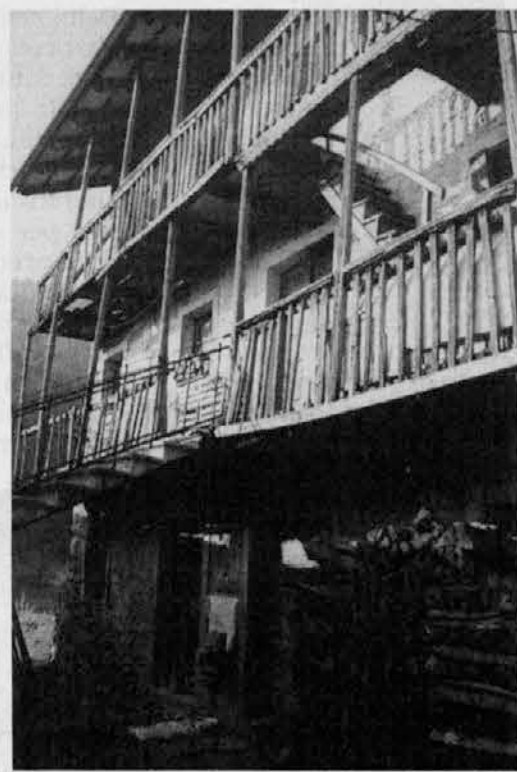
Una casa di Topolò in attesa del recupero edilizio da parte della Regione
