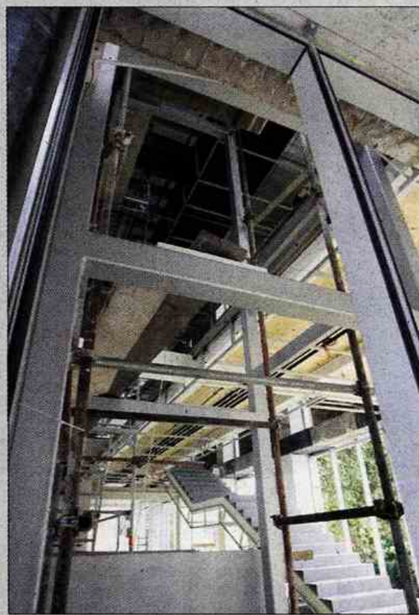
Nesreča se je zgodila pri montaži prečnika za dvigalo. Delavec je padel z železne konstrukcije na višini približno desetih metrov.
