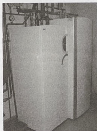
Toplotna črpalka, ki odvzema toploto iz zemlje in ogreva celo hišo in sanitarno vodo. Sprejeto je toplotna črpalka, zadaj hranilnik za toplo sanitarno vodo.
