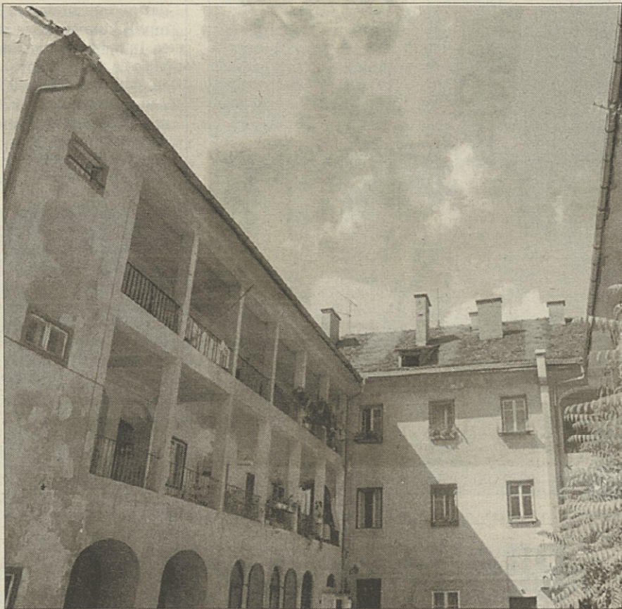
Stanovalci nemočno čakajo, kdaj se bo hiša zrušila (Foto: Boban Plavevski)
