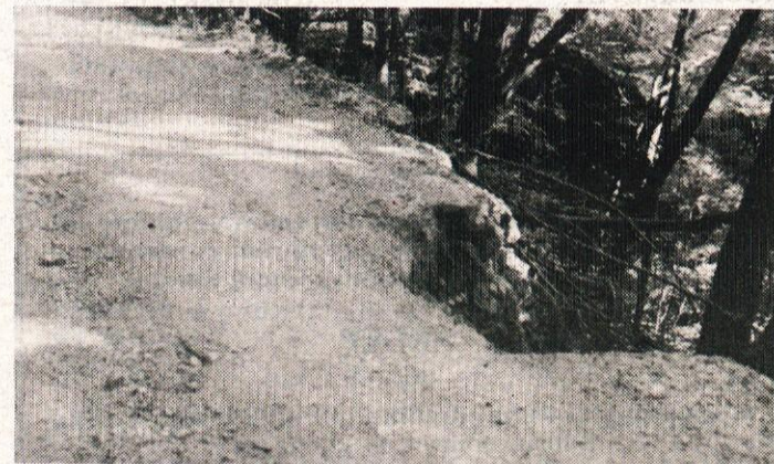
NEVARNA CESTA — Krajan Butajnov nad Horjulom morajo biti zadnje čase kar se da previdni, ko se peljejo iz bližnje Ljubljane proti domu. Le malo preden njihova cesta pripelje iz gozda, sta na njej nastala dva nevarna zemeljska udora, kjer nepazljivega voznika kaj hitro lahko vrže čez rob. Nevarno je še zlasti ponoči, saj udora nista z ničemer označena. Učinkovita rešitev bi bila seveda samo škarpa, tako kot je s škarko podprt že del te ceste.
