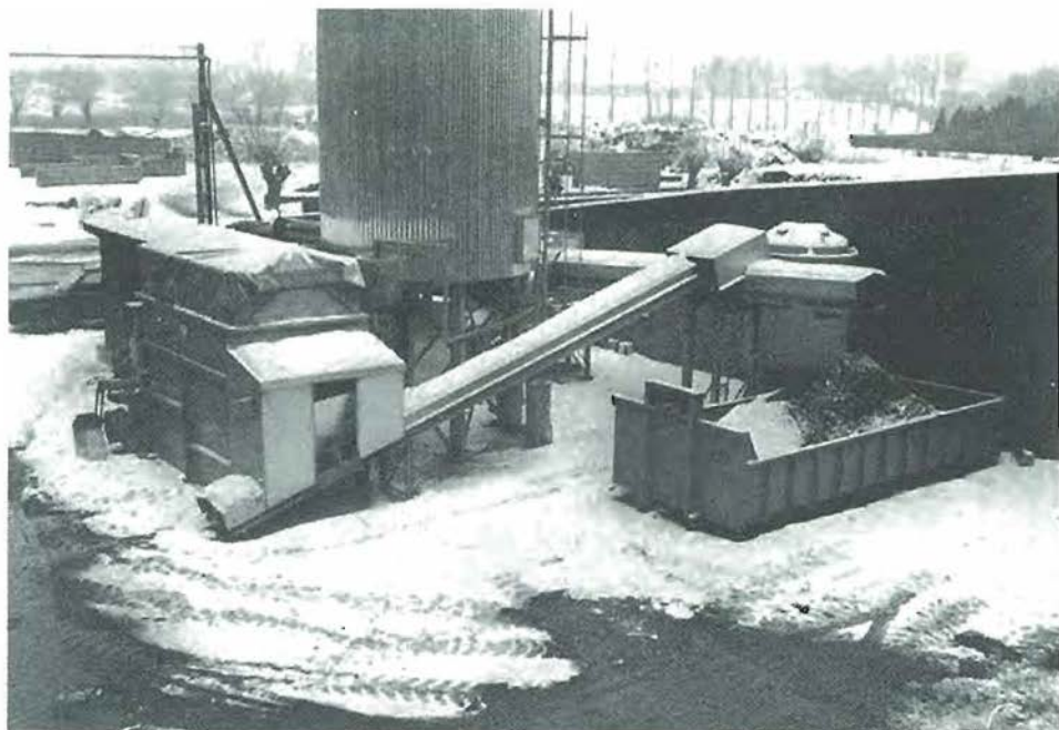
Sl. 3: Del tovarne (reaktor z opremo) za predelavo trdih komunalnih odpadkov po tehnologiji DRANCO, Francija. Zmogljivost 120 ton odpadkov/dan. Proizvodnja: 60–100 m 3 metana/tono. Netoproizvodnje: 200–300 kWh električne energije/tono odpadkov = 1,5 MW/dan in 50 ton kakovostnega komposta/dan. Vir: Prospekt firme Arbios s.a. Francija.
