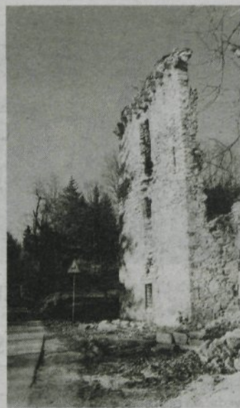
Severno zahodni del gradu grozi, da se bo podrl na cesto.
