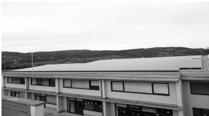
Sedaj se poleg športne dvorane tudi učilnice ponašajo s t. i. sončno streho, njena skupna moč je 437 kW. Foto: Gregor Arko.
