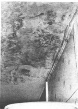
Takšen je strop, na omari pa vedro, ki ga je ob obilnem dežju treba večkrat izprazniti
