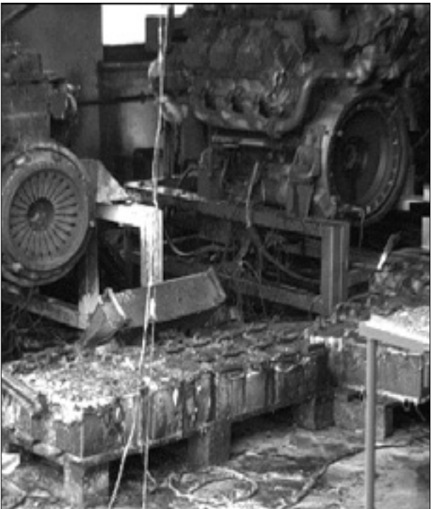
V požaru poškodovana oprema
