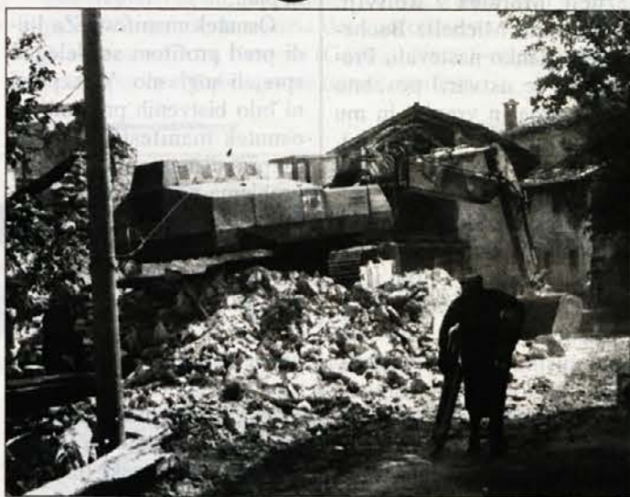
Una delle foto di Petricig che saranno esposte alla Beneška
