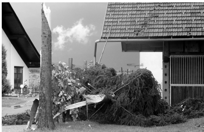
Odlomljena smreka je delno poškodovala kritino
