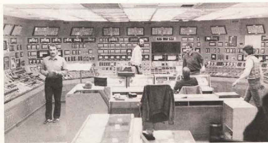
GLAVNI KONTROLNI PROSTOR, z računalniki, ki nadzorujejo vso elektrarno. Tam so stalno navzoči štirje strokovnjaki, ki ne smejo zapustiti prostora. Delajo v treh izmenah. Nепrestano se morajo strokovno izpopolnjevati.
