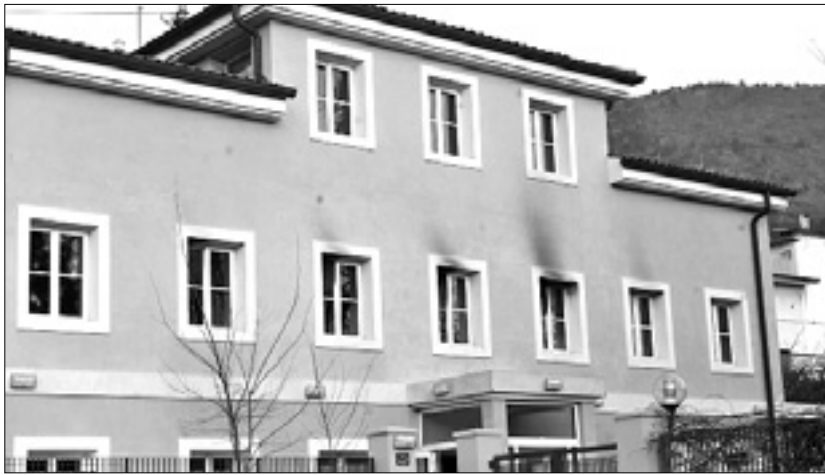
Požar se je vnel v sobi v osrednjem delu stavbe
