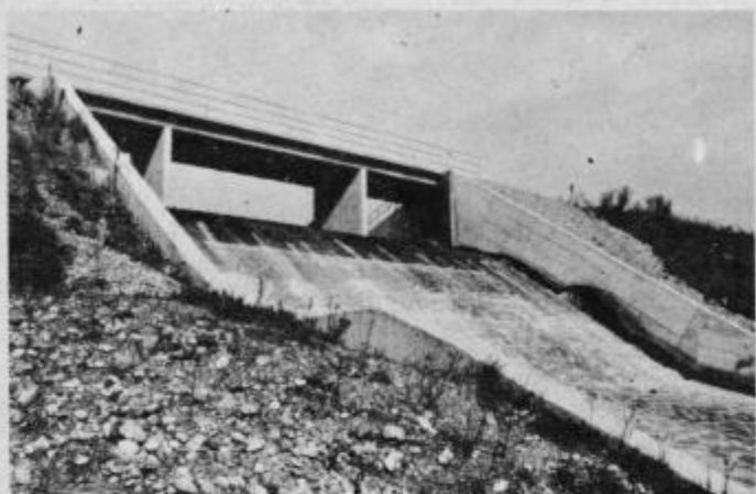
Razbremenilnik, ki visoke vode Pesnice spelje v kanal SD 2
