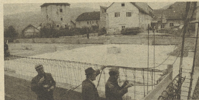
Med gradnjo se je pokazalo, da je gradbišče zelo močvirno, zato so položili točkovne temeljne in stavba „plava“ na nepropustni plastični podlagi.
