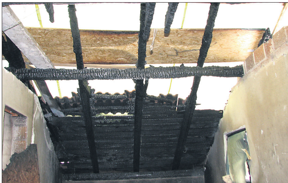
Hrzenjakova hiša v Gruškovcu 85 je ostala brez strehe in ostrešja.
