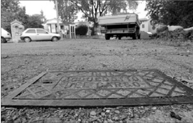
Vodovodno omrežje v Medji vasi upravlja Kraški vodovod
