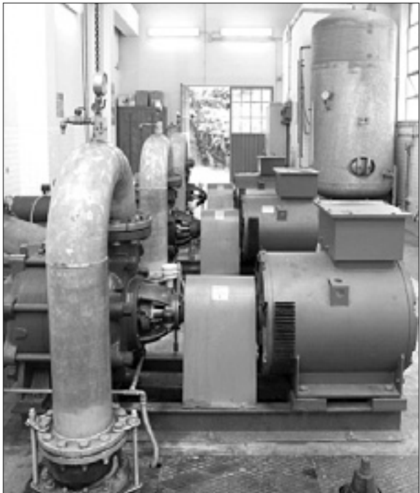
Električne črpalke ronškega vodovoda
